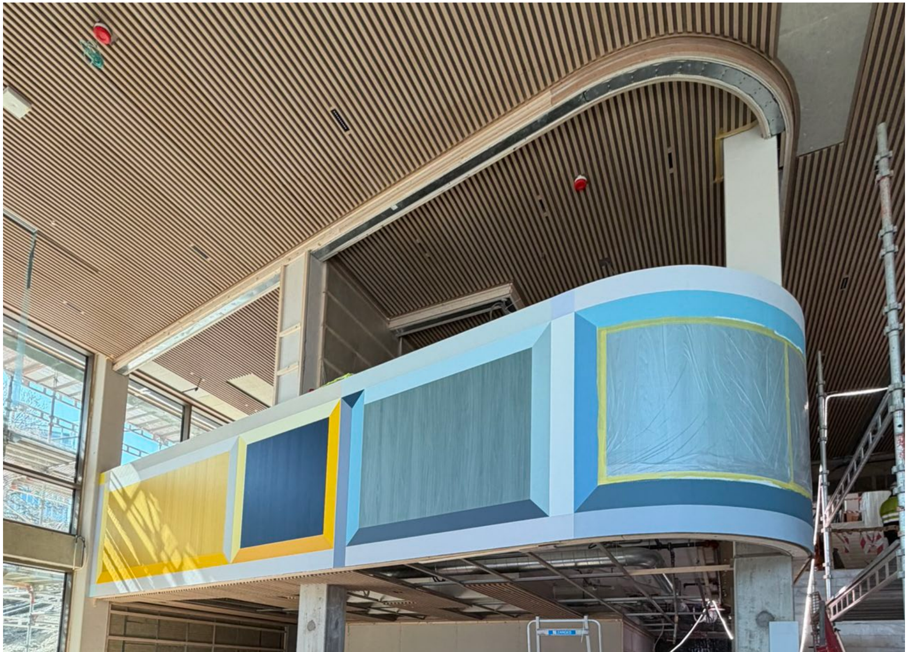
Stavanger Rådhus | Link Arkitekter | Faber Bygg | Kunstner Anders Sletvold Moe Installasjonskunst malt på Acsono mikroperforerte panel med Tabu finer.
